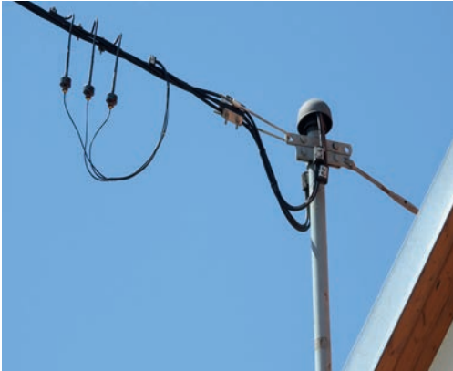
Abspannung an Dachständer
